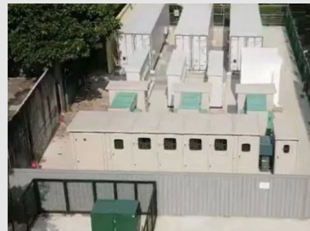
土城7MW儲能案場
